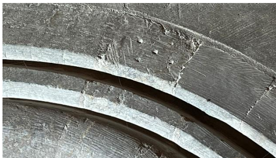
Figur 6 Hardt restaurert murverk i Johanneskapellet. Bare borehull igjen av steinhuggermerket. Foto: K. Kristoffersen.
